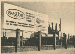
La subestación Edison incorpora dos poderosos transformadores.
