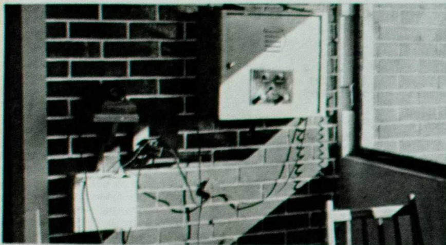
EL PUESTO POLICIAL DE VILLA DEVOTO CON LOS CABLES SUELTOS.
